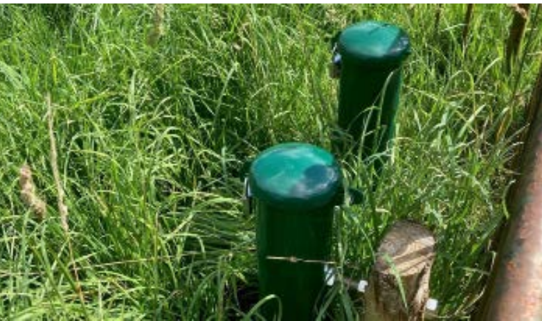
▲ Peilbuizen helpen inzicht te krijgen in de toestand van een kering.
